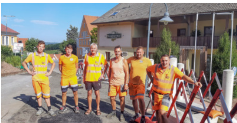
▲ Die Stiege zwischen dem ehemaligen Ghafour-Haus und GH Stradnerhof wurde saniert und ist nun wieder sicher für die Fußgänger zu benutzen.
